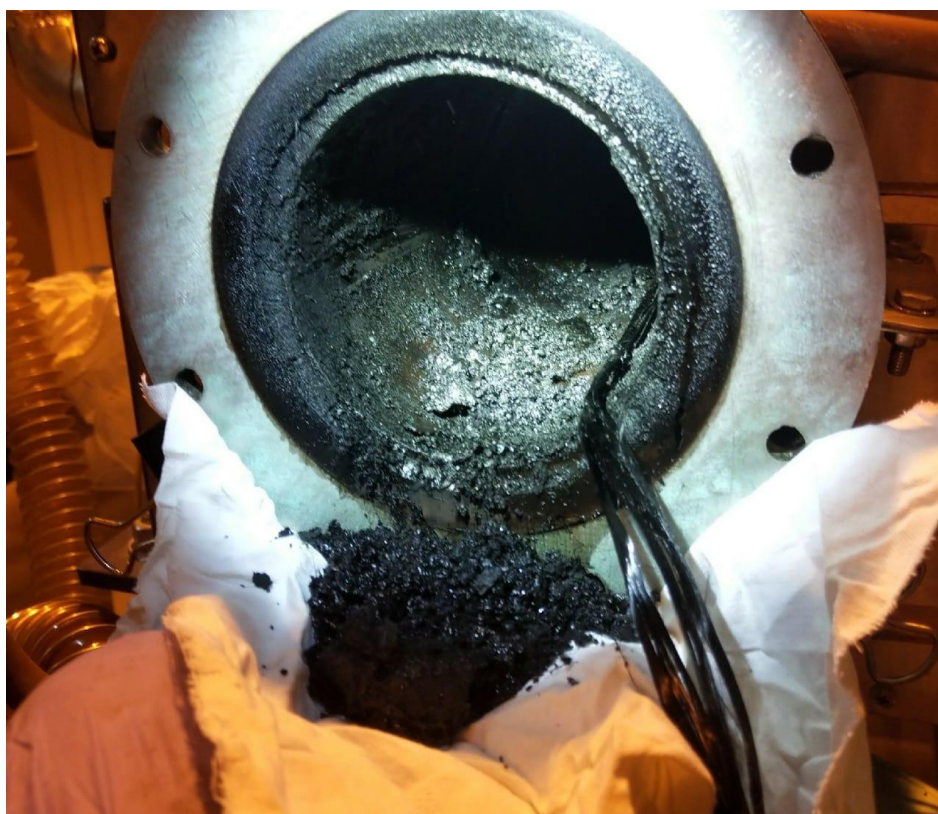
Рисунок 14 — Очистка от конденсированных смолистых веществ входного затвора печи низкотемпературной карбонизации
