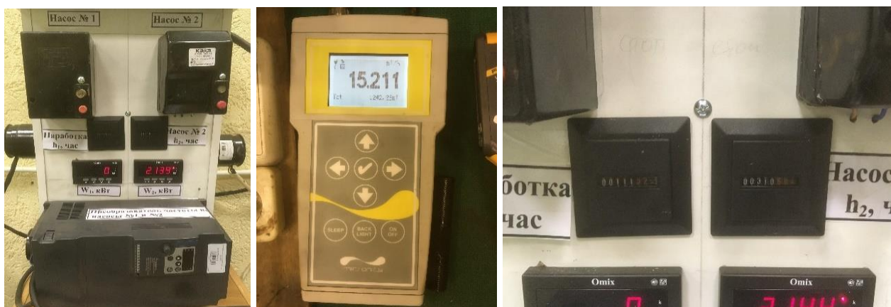
Рисунок 62 – Пусковой щиток насосов (слева), расходомер (в центре), датчики наработки (справа)
